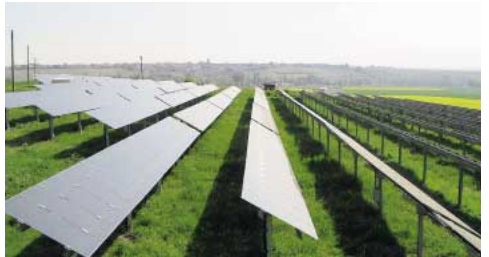
Konzeption, Planung und Bau von Photovoltaik-Freiflächenanlage ist eines der Tätigkeitsfelder der Rytec GmbH, deren Niederlassung Baden-Baden in der Cité zuhause ist.
