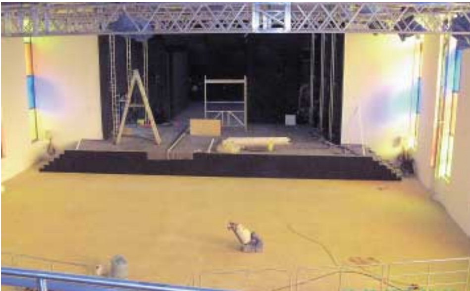
Kurz vor der Fertigstellung: Die neue Simulationsbühne der EurAka mit modernster Bühnentechnik im komplett sanierten ehemaligen Kirchengebäude in der Cité. Foto: AW
